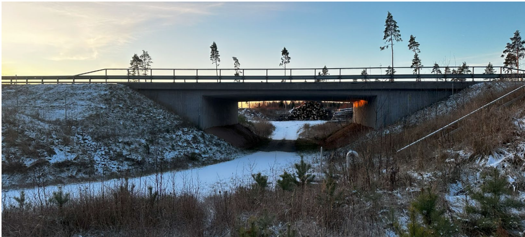
Figur 5 Faunapassagen under väg 44
