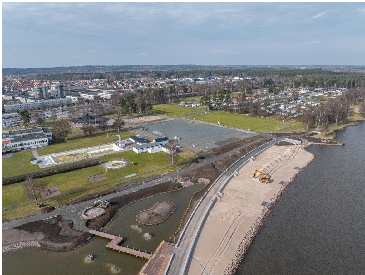
Figur 3. Drönarfoto som illustrerar pågående arbete med anläggning av ny strandpromenad med tillhörande sandstrand. Bild erhållen av Lidköping kommun 2025-03-04.
